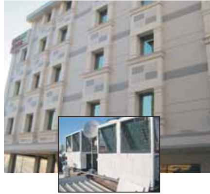
Realist otel, Haramidere 2x70kW-Isıtma-Soğutma
